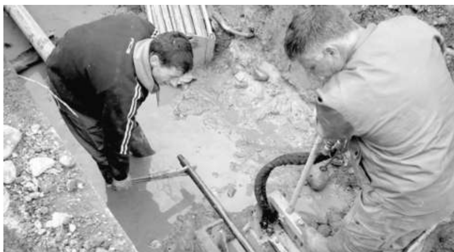
Заради лошото състояние на ВиК мрежата у нас над 60 процента от питейната вода се губи
